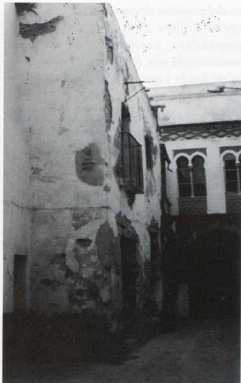
Casa Hermandad. Estado en que se encontraba la casa cuando se adquirió.
